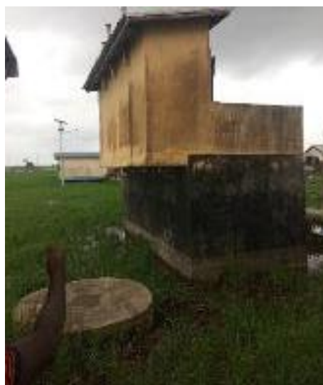
Bloc sanitaire conventionnel à fosses surélevées (So Ava – 2014)
