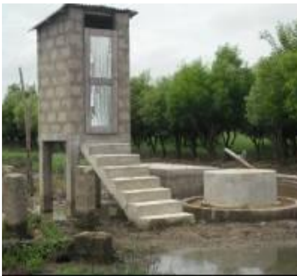
Toilette surélevée à lit filtrant
