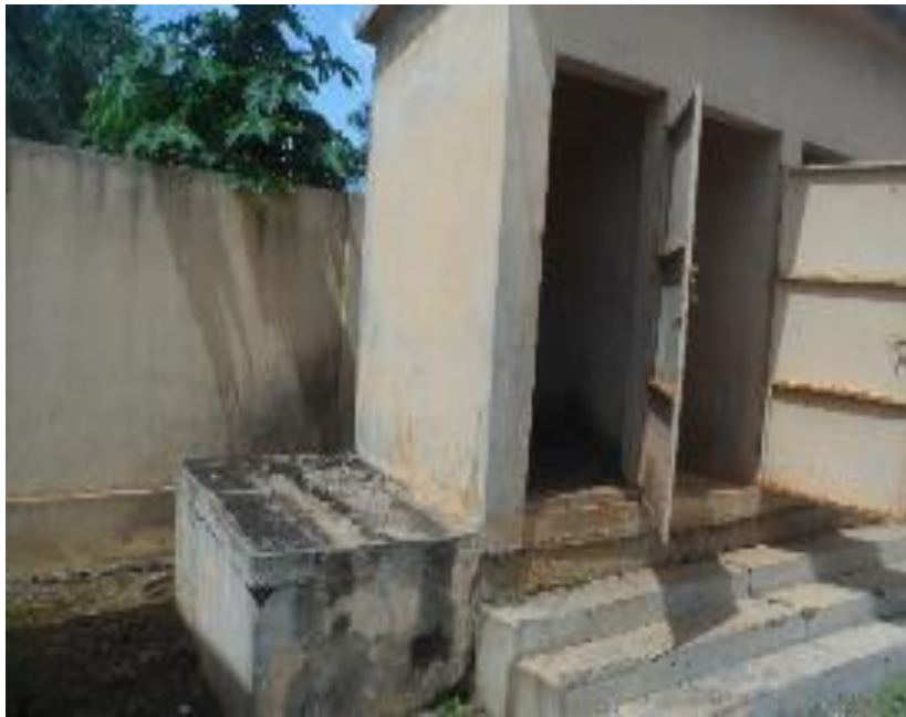
Latrine VIP double fosses surélevées (Ouedeme – 2008)
